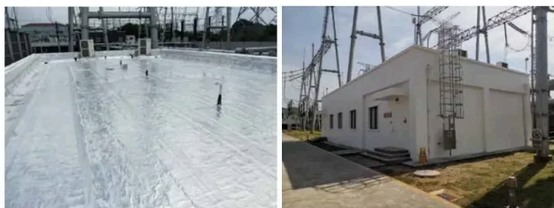
Exemples d'applications sur locaux techniques et sous-stations.
